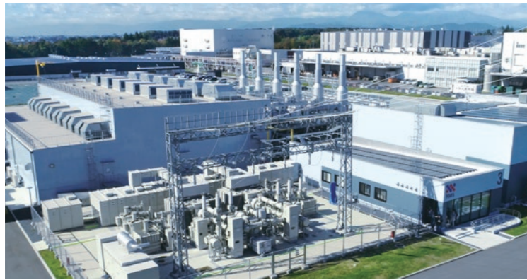
清原スマートエネルギーセンター (栃木県宇都宮市)
