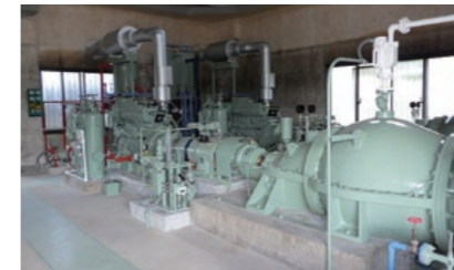
復旧後の小川排水機場ポンプ設備
